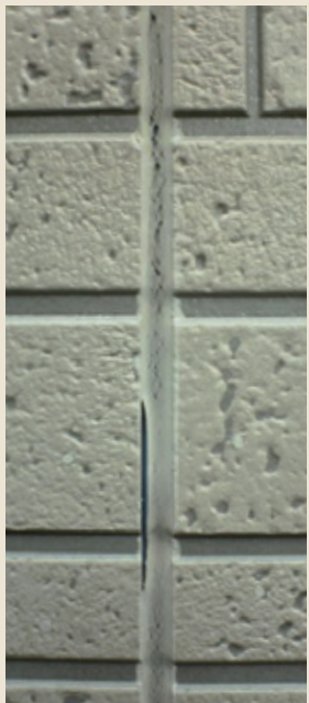
接着不良(剥離)
